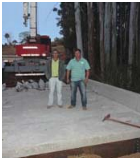
O subprefeito de Lagoa Branca Rubens Scapin e o vereador Claudenir acompanharam a instalação da nova ponte
