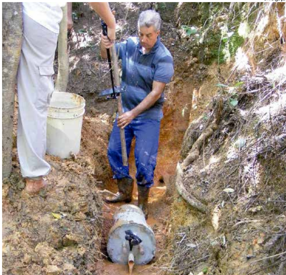
Sustentabilidade: com o apoio da Cati, projeto já realizou a instalação de duas fontes modelo Caxambu; sistema tem baixo custo e tem grande eficiência na proteção de nascentes
